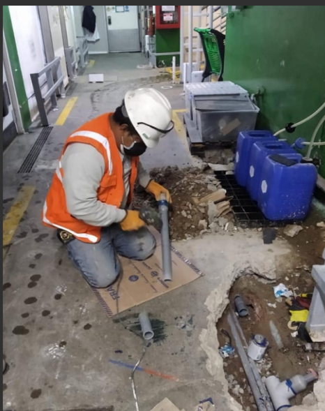
Conexiones de agua y desague
