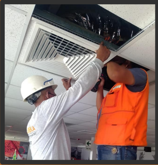
Extractores de aire
